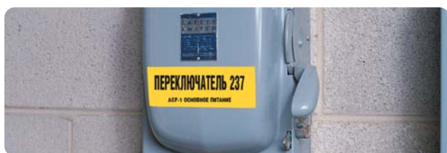
Общая маркировка оборудования
